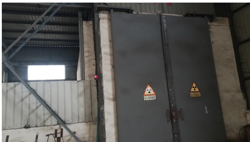
B 防护门、警示标志、警示灯正常运行
